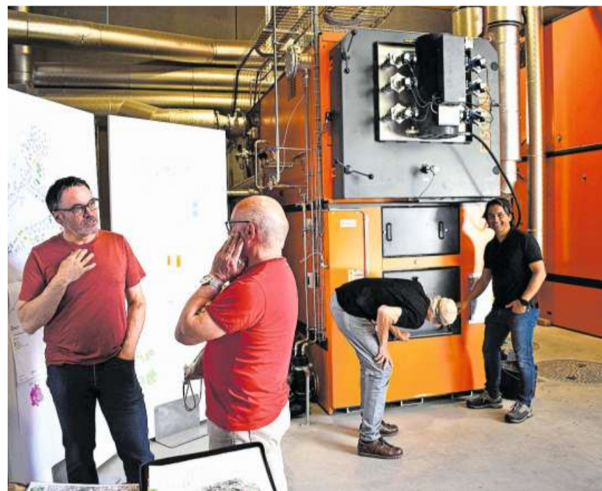
Frühlingsmarkt-HGH: reges Interesse an der Holz-schnitzel-Heizzentrale. Förster Robi Püntener (links) und Oliver Weisbrod (rechts) erklären den Betrieb.
